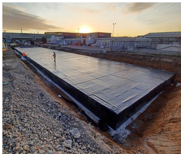
Installation med membrantæt magasin
